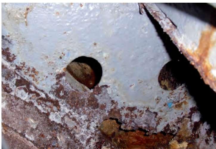
Figura 6 Un madiere metallico con la zona bassa completamente corrosa (scheda 5.1.5B).
